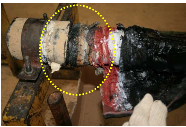
Voda nalezená v kabelu během odkrývání spoje. Koroze CAS na vnitřní straně kabelové objímky u Sumitomo
