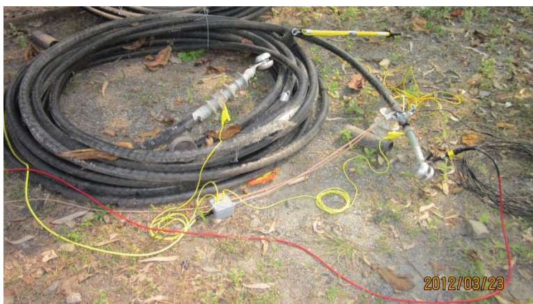
Obr. 64: Uspořádání zapojení s ochranným kroužkem a korónovými kryty, VSE-box, připojení přístroje Frida TD
