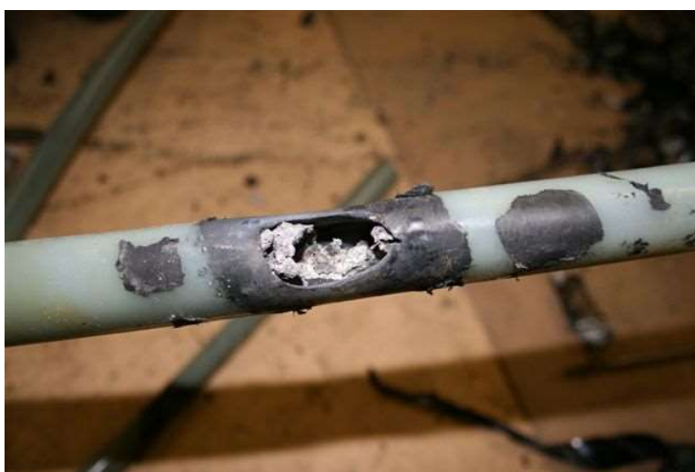
Porucha tělesa kabelu, L2 na 125 m
