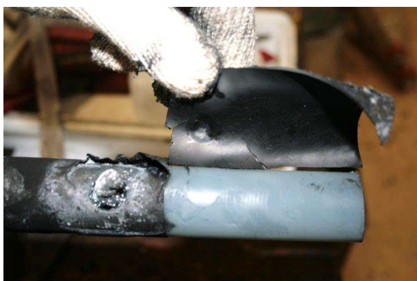
Známky vody zaznamenané v izolačním stínění
