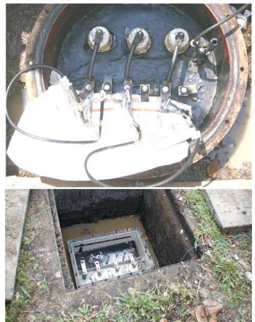
Obr. 9.2: Přístupné spojovací skříně, s připojenými přemostovacími vodiči u můstkových metod
