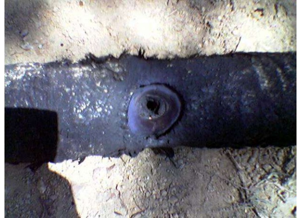
Obr. 9.21: Porucha u kabelu 132 kV PILC
