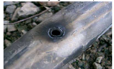
Obr. 7.4: Porucha kabelu, 1žilový kabel 11kV XLPE
