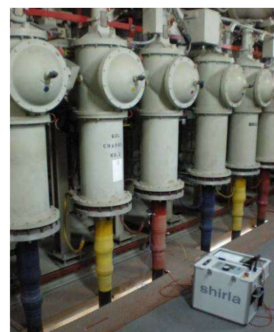
Obr. 5.27: Shirla – systém k lokalizaci poruch kabelů připojený k izolované rozvodně SF6, 66 kV
