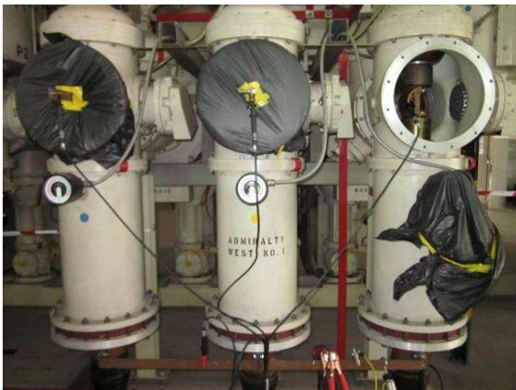
Obr. 9.3: Koncovka: Ang M. K. 6 6kV rozvodna, SF 6
