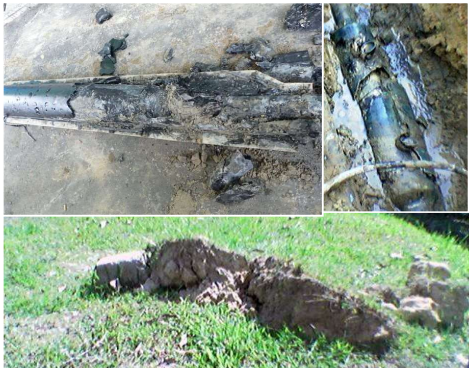
Obr. 9.20: Spoj 132 kV po explozi při poruše kabelu, 132 kV XLPE, při explozi došlo k vyzvednutí zeminy nad místem poruchy
