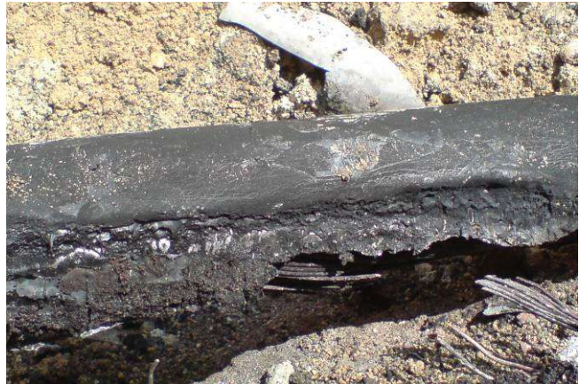
Obr. 9.19: Vypařená žíla po poruše kabelu, 132 kV XLPE
