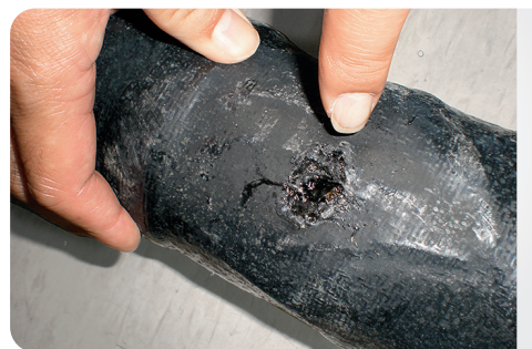
Poruchy kabelů s papírovou izolací
